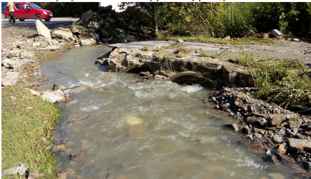
Obr. 10 Mostný objekt v Čadci – znížený prietokový profil, jeho deštrukcia
