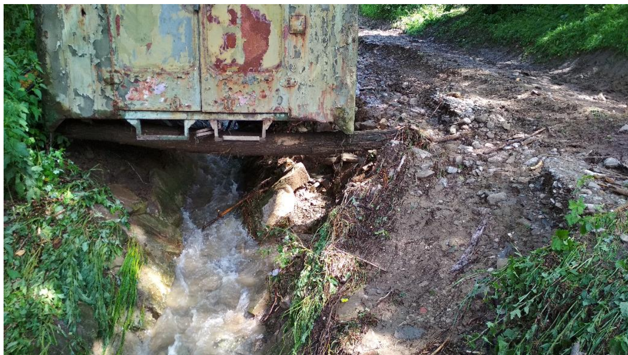
Obr. 9 Prekážka na miestnom toku v obci Lednica, ktorá mala vplyv na jeho vybreženie
