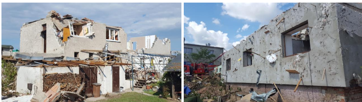
Obrázok 3. Vľavo: vážne poškodený obytný dvojdom s takmer úplne zničeným vrchným poschodím; vpravo: ukážka pôsobenia extrémne rýchlo letiacich projektilov do steny budovy - práve tieto trosky sú najväčším rizikom pri tornádach (foto: M. Šinger).
